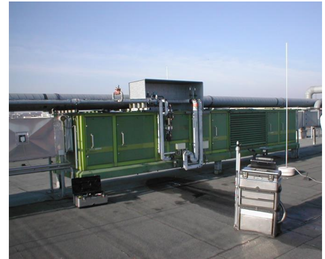
Foto: RLT-Anlage Dachgerät
