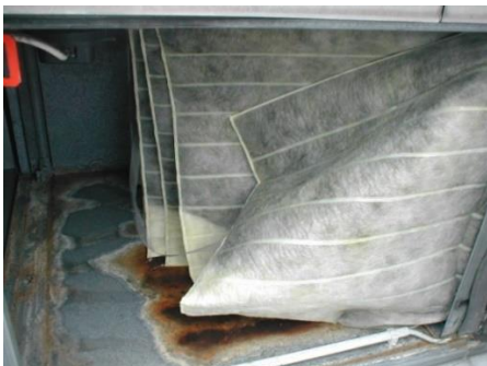
Foto: Filter in einer RLT-Anlage
