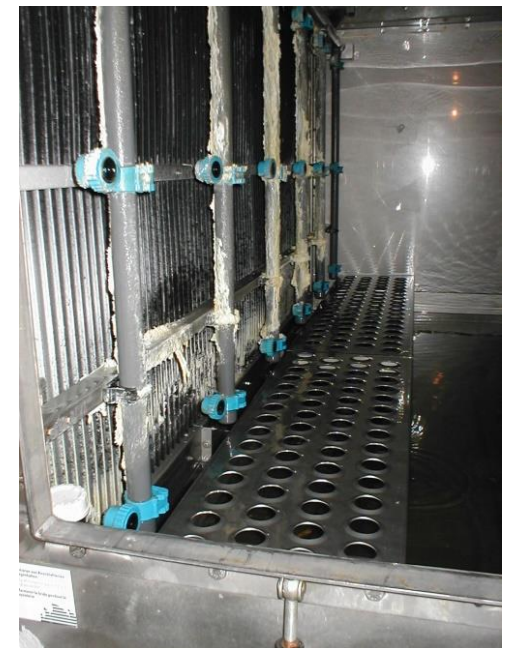
Foto: Sprühbefeuchter in einer RLT-Anlage
