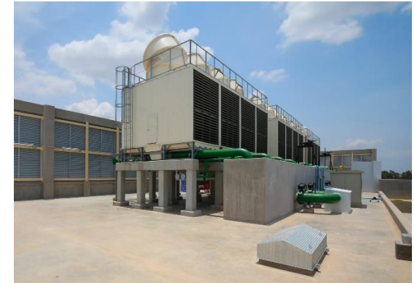
Foto: Offene Verdunstungskühlanlage
