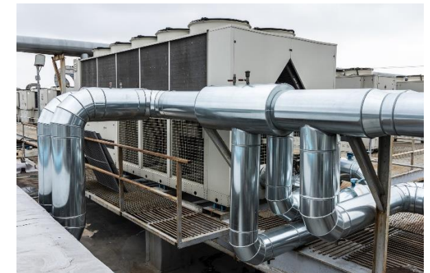
Foto: Offenes Rückkühlwerk
