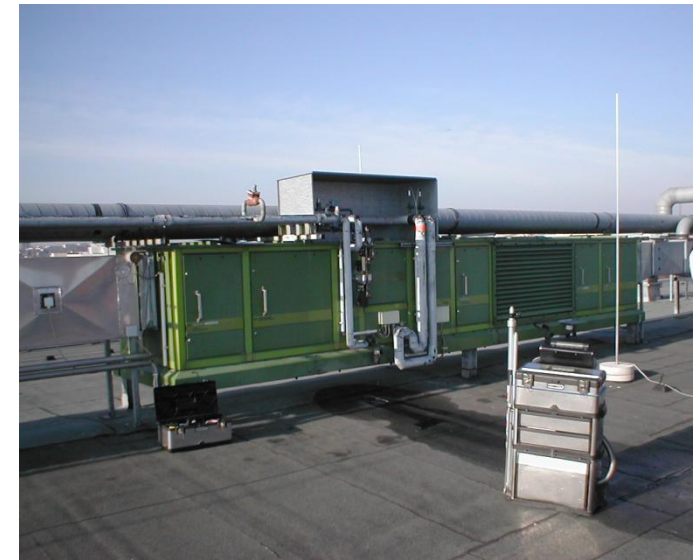
Foto: RLT-Anlage Dachgerät
