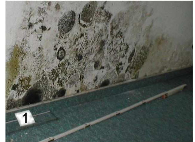
Abb.: Schimmelpilze nach Wasserschaden, an der Wand versteckt hinter einem Sideboard
